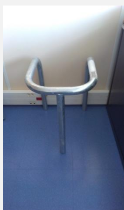
Figure 34 : Protection en fer conçue pour les coffrets régulièrement couchés.
