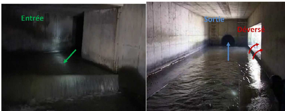
FIGURE 5.1: Le déversoir d'orage d'Herbet
