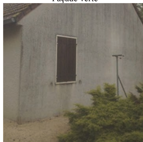
Figure I- 2 : Exemples de biodétérioration des façades
