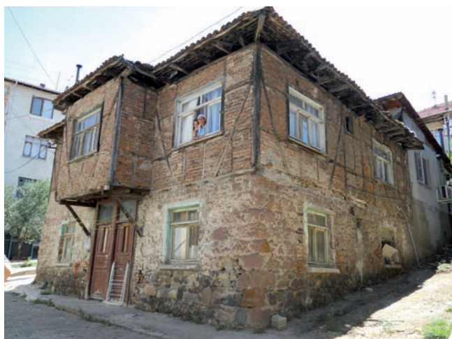
Gölcük : structure en maçonnerie et himış (briques en terre cuite); elle n'a pas subi des dégâts lors du séisme de Kocaeli de 1999
