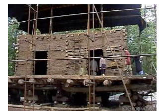
Système en zagmeh : boîte continue surélevée et remplissage avec un mortier en terre fibrée
