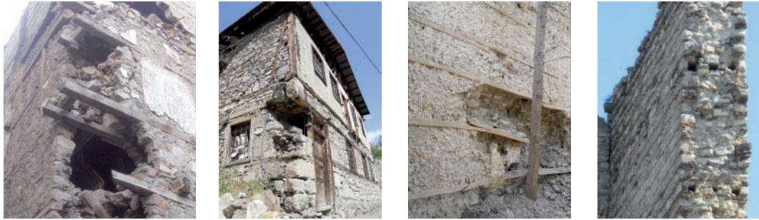
Fig.120: Insertions en échelle (Turquie) assurant la stabilité du mur (a) et des étages supérieurs (b) en cas de défaillance localisée aux angles ou dans le plan du mur (c) ; d) le mur théodosien présente des traces d'insertions horizontales selon le même principe mais avec triple poutre (Istanbul)
