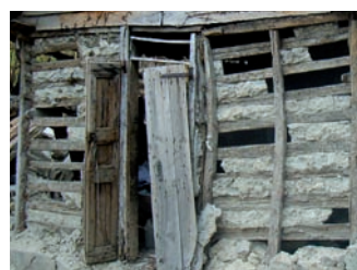
technique du tiwoch : dommages causés par le séisme de 2010
