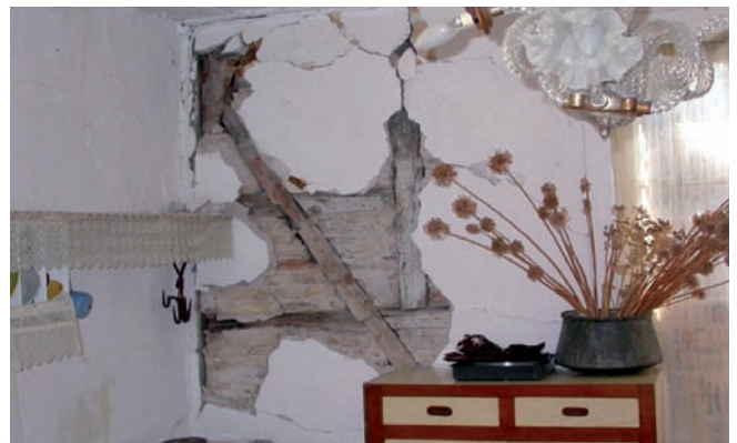
Effets du séisme du 14 août 2003 : détachement de l'enduit et fissuration de la maçonnerie au rez-de-chaussée
