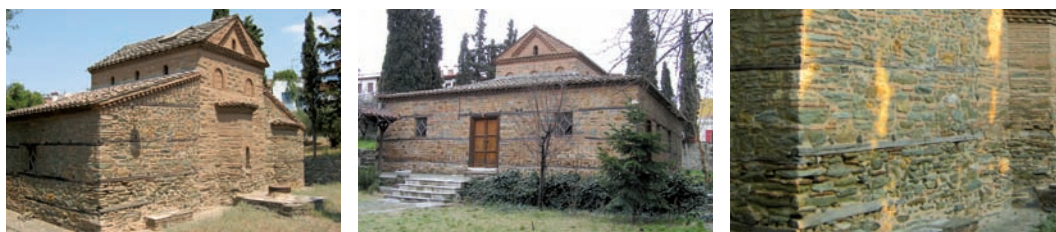
Fig.114: Basilique de Agios Nikolaos (Thessaloniki, Grèce) : a) déambulatoire avec insertions adossé au corps principal en maçonnerie simple, b) façade principale, c) détail des insertions horizontales en bois (crédits a et b: Buchhändler ; source c: a3-3gymthes.blogspot.com)
