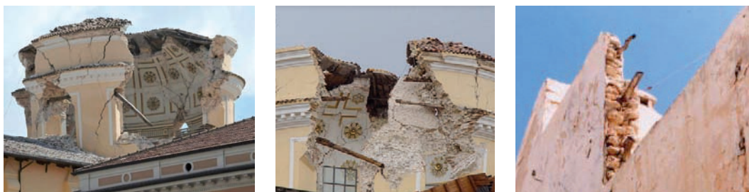
Fig.115: Insertions en tirant en bois : église de Santa Maria del Suffragio après le séisme de 2009, L'Aquila (Italie) : a) vue de la coupole (source: focus.de) et b) détail des insertions (source: LAGOMARSINO, 2012) ; c) tirants en bois dans maçonnerie en pierre brute hourdée, Tunisie (source: MEDA CORPUS, 2011)
