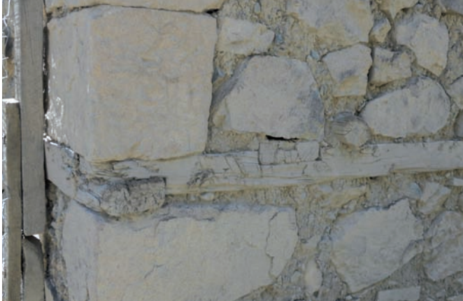
assemblages / entailles à mi-bois de connexion entre chaînages perpendiculiers et entre chaînages et traverses
