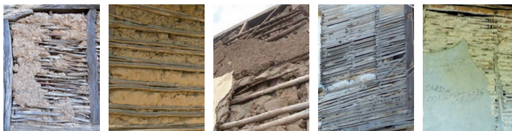
Fig.102: a) torchis (Turquie) ; b) remplissage en terre confiné (Guatemala, crédits: M. Mas Gomes) ; c) taquezal avec gravat (Nicaragua, source: QUINTALLET, SAMIN, 2012) ; d) bağdadı (Turquie) ; e) effet du séisme de 2010 sur un panneau en klissage avec mortier de terre chaux (Haïti)
