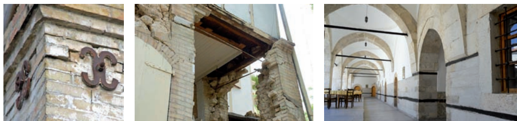
Fig.116: Insertions en tirant métalliques : maisons gingerbread , Port-au-Prince (Haïti, source: LANGENBACH, KELLEY, SPARKS, ET AL., 2010), (a) plaques d'ancrage et (b) dégâts sans effondrement complet lors du séisme de 2010 ; c) association entre tirants métalliques et insertions horizontales en bois dans le caravansérail Cinci Han, Safranbolu (Turquie)
