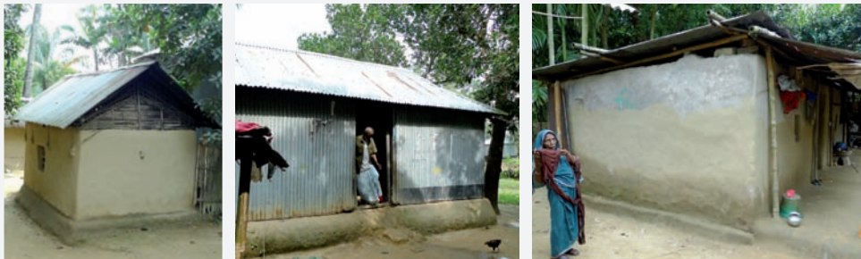
Fig.44: a) construction en terre massive ; b) nouvelles pratiques constructives ; c) réparation d'une habitation en terre crue suite à une inondation
