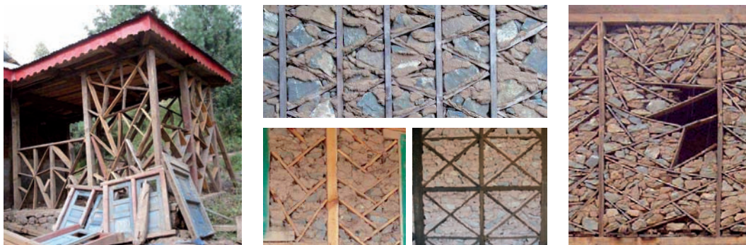
Fig.100: Cachemire pakistanais, dhajji dewari : a) structure vide ; b, c et d) variante de remplissage ; e) dégâts suite au séisme de 2005 (crédits : a, b et e) T. Schacher ; source : c et d) HIÇYILMAZ, BOTHARA, STEPHENSON, 2011)
