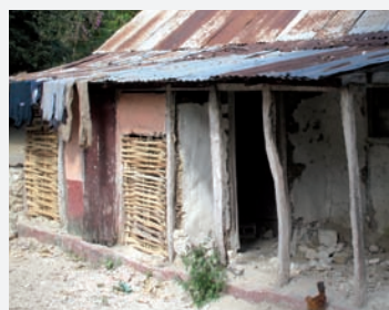
Fig.42: a) effondrement du remplissage en maçonnerie ; b) décollement de l'enduit et réutilisation des panneaux (gauche) (crédits: E.Cauderay)
