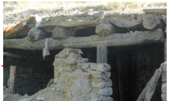
dissociation structure mur-toiture / les poteaux indépendants assurent le maintien de la structure de toiture même en cas d'effondrement du mur en maçonnerie
