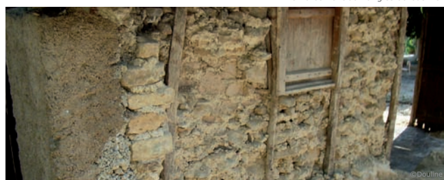
Écroulement de la face externe du mur lors du séisme de 2010
