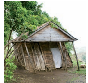
Instabilité de la structure
