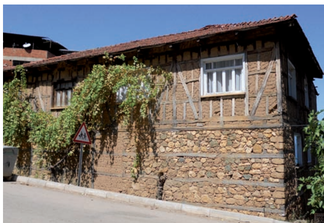
Narlıca : structure mixte avec rez-de-chaussée en maçonnerie en pierre avec hatillar en bois et étage en himış (briques en terre crue)
