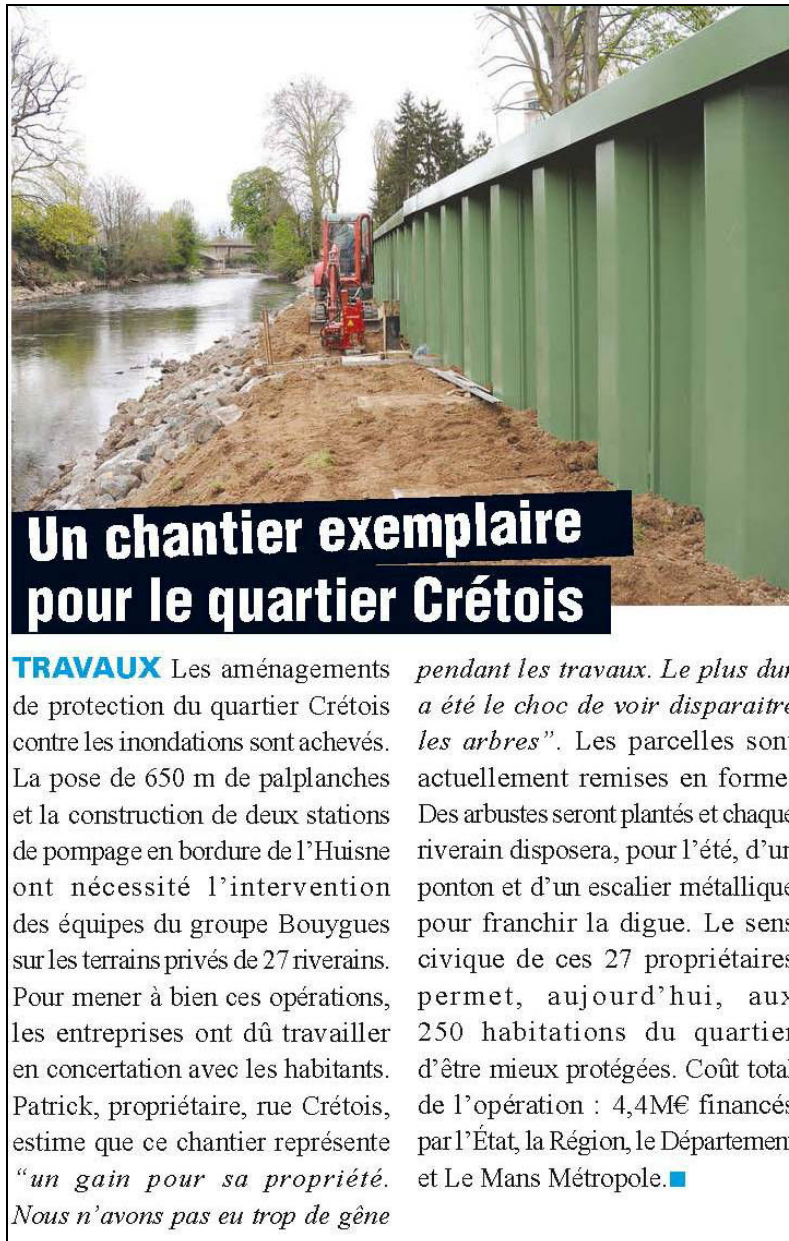
Figure 23 - La fin des travaux de protection locale contre les inondations dans le quartier Crétois au Mans (Le Mans notre ville métropole, N° 251, mai 2014).
