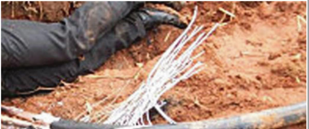
Un voleur de câbles électrocuté
