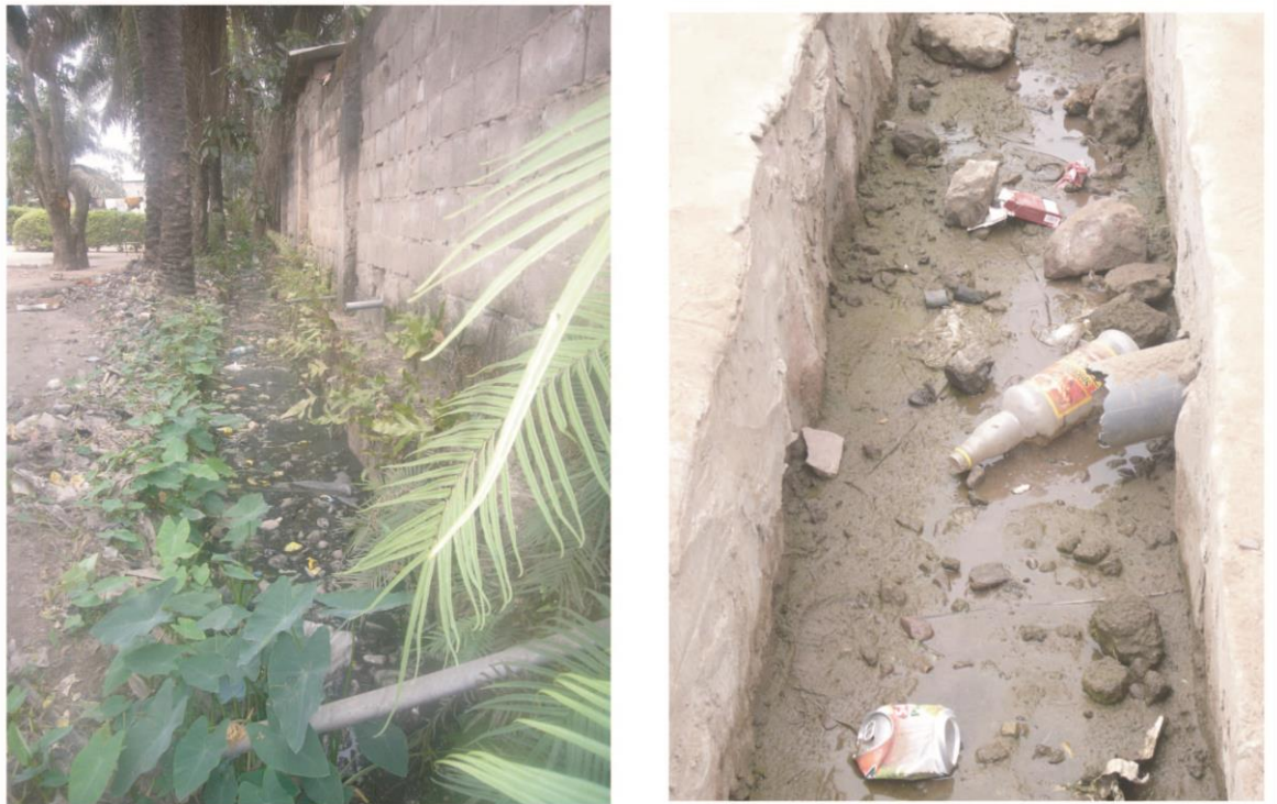
Les tuyaux d'évacuation des eaux usées sur la voie publique
