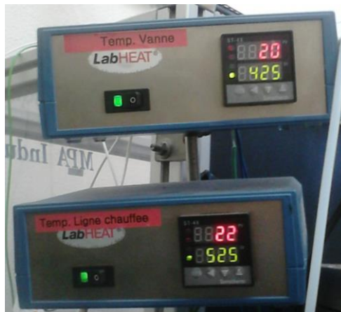
Figure 28 : Contrôleurs de température des rubans chauffants de la vanne HT et de la ligne HT.
