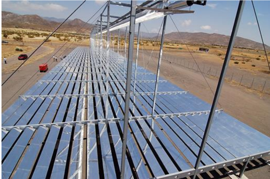
Figure I-13. Photo de l'installation FRESDEMO [23]
