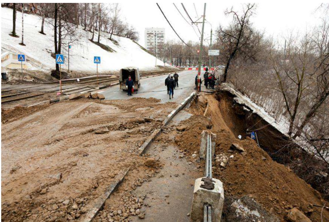
Figure 15. Le glissement de terrain à la descente Zelenski, avril 2012, URL: http://imhonn.ru/u/ed/dd/diary/182/text/1346331787.jpg , consulté le 12/02/14.
