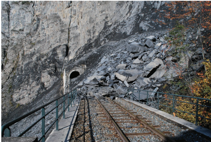
FIGURE 1.3 – Eboulement de la Clapisse du 26 octobre 2010. Le volume éboulé est estimé à 3000 \text{ m}^3 dans les roches argilo-schisteuses du Lias. L'éboulement a recouvert la voie ferrée du chemin de fer de la Mure, entraînant l'arrêt de son exploitation depuis cette date.
