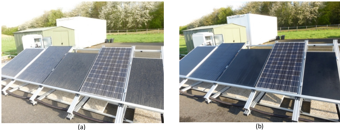
Fig.6.18. Photographie de la plateforme PV1 dans un état critique de salissure (a) et le lendemain, après une averse (b)
