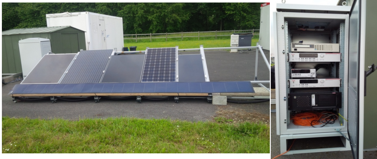
Fig.6.24. Plateforme PV1 installée au SIRTA en Avril 2014 (gauche) et son instrumentation (droite)
