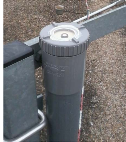
Fig.6.12. Fibre optique protégée par des tubes PVC
