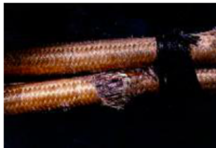
(c) Défaut thermique
