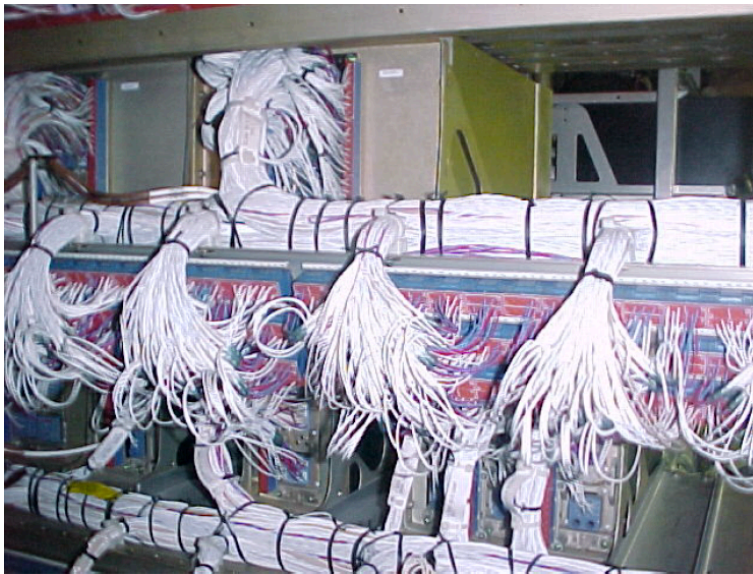
FIGURE 1.2 – Câblage à l'arrière du race électrique d'un avion de transport en service (source : [88]).
