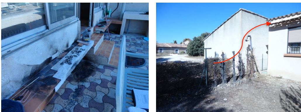
Fig. 64 : Dommages observés sur l'habitation CAV_2 : (a) façade endommagée par la combustion du matériel en bois entreposé ; (b) endommagement de la gouttière en PVC suite à l'incendie de la haie de cyprès vert.
