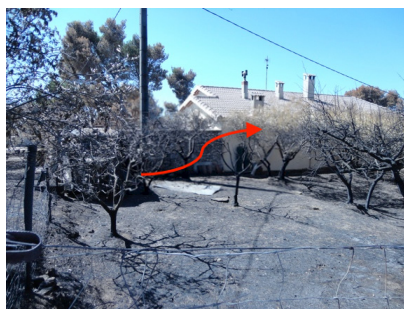
Fig. 66 : Dommages observés sur l'habitation CAV_8 : gouttière endommagée suite à l'incendie d'un camion et de son effet sur la végétation environnante
