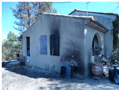
Fig. 65 : Dommages observés sur l'habitation CAV_6 : façade et volet endommagés par la combustion d'un banc en bois accolé à la maison
