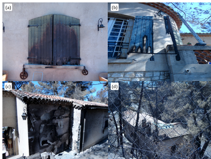
Fig. 68 : Dommages observés sur l'habitation CAV_8 : (a) volet en bois (façade sud-est) dégradé par la combustion d'un banc en bois accolé atteint par des brandons ; (b) volets façade sud-est partiellement détruit par l'exposition au rayonnement thermique (auto-inflammation) ; (c) façade nord-ouest endommagée par la combustion d'un établi en bois accolé ; (d) toiture endommagée par les brandons
