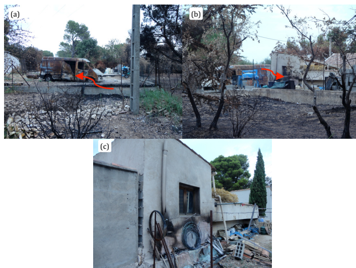
Fig. 67 : Dommages observés sur l'habitation CAV_13 : (a) un stock de bois entre en contact avec le feu, sa combustion entraîne celle du camion ; (b) l'incendie du camion impacte par rayonnement le matériel stocké au pieds de la maison et brise la vitre (c)
