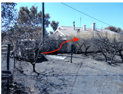
Fig. 66 : Dommages observés sur l'habitation CAV_8 : gouttière endommagée suite à l'incendie d'un camion et de son effet sur la végétation environnante
