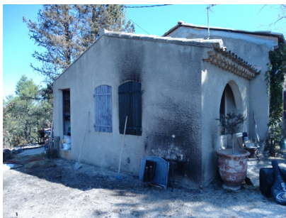
Fig. 65 : Dommages observés sur l'habitation CAV_6 : façade et volet endommagés par la combustion d'un banc en bois accolé à la maison
