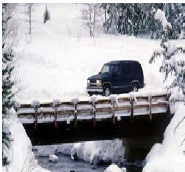
Figure 0. 1 Un pont sous la neige - risque de corrosion par le sel de déverglaçage
