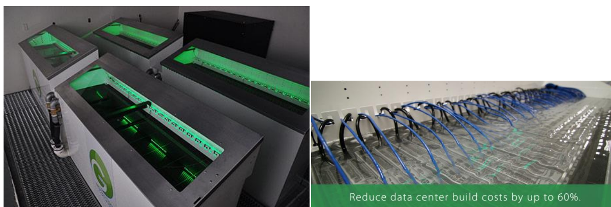
Figure 23 : système de refroidissement par bain d'huile minérale développé par Green Cooling Revolution
