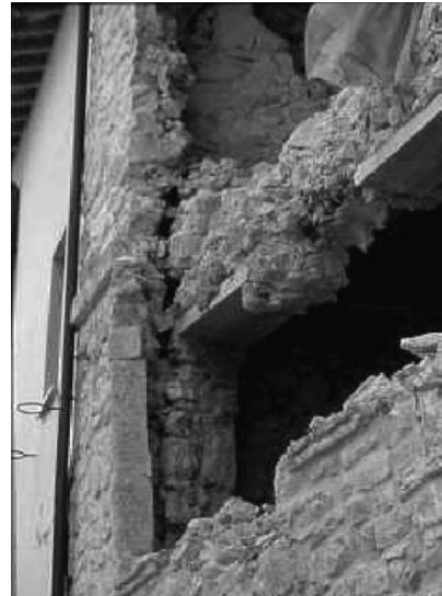
(b) : déformation hors plan par séparation des couches dans le mur [24]
