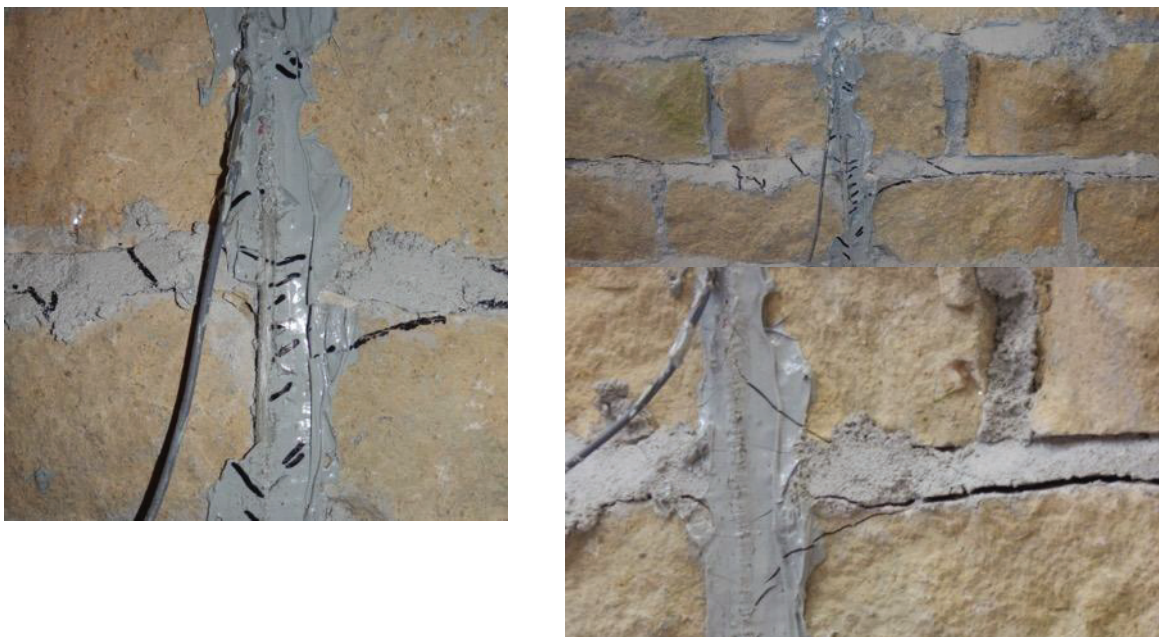
Figure V.10 : Mode de rupture de l'essai de flexion 3 points : mur renforcé avec une barre verticale de GFRP M4-NSM-1BV
