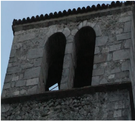
(a) arc de décharge
