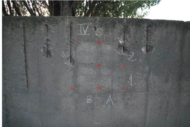
Fig. 4.33. Photo du mur IV-Sud avec la délamination du béton
