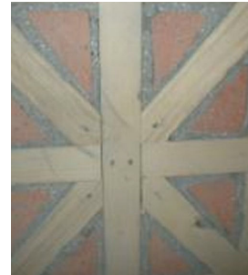
(c) Faibles déformations de l'assemblage central
