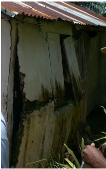
(a) Rupture des panneaux clissés due à un manque de maintenance
