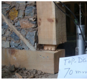
(a) Rupture de la connexion basse du poteau d'extrémité
