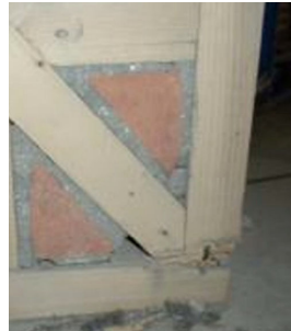
(b) Rupture en traction du tenon
