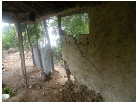
(b) Chute des panneaux de remplissage due à un manque de maintenance et à un problème de conception, [8]
