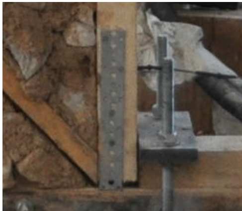
(c) Endommagement de la connexion de type-1 du mur élémentaire avec remplissage à la fin du test cyclique
