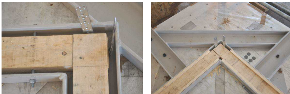
(a) Positionnement du cadre dans le profilé métallique (b) Serrage des lisses par l'intermédiaire de cale en bois et de tige filetées boulonnées
