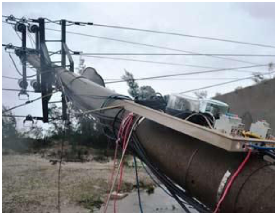
Fig. 1-21. Un pylône déraciné dans une tempête au centre du Vietnam en octobre 2013 [RUP-web1]
