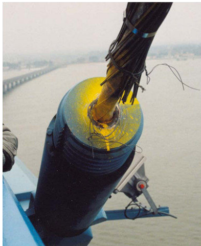
FIGURE 1.6 – Endommagement d'un hauban par fretting-fatigue [19]
