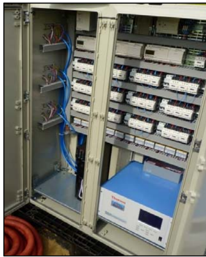
Figure II.3 : Coffret électrique mis en place dans la bande enherbée.
