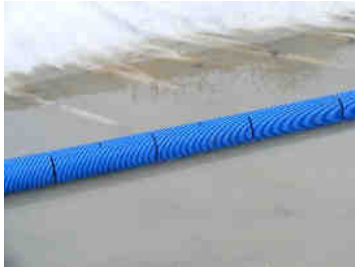
Figure 4-19. Filtre n°3 - Vue détaillée du drain de collecte installé en fond de filtre (le 24/04/2012)
