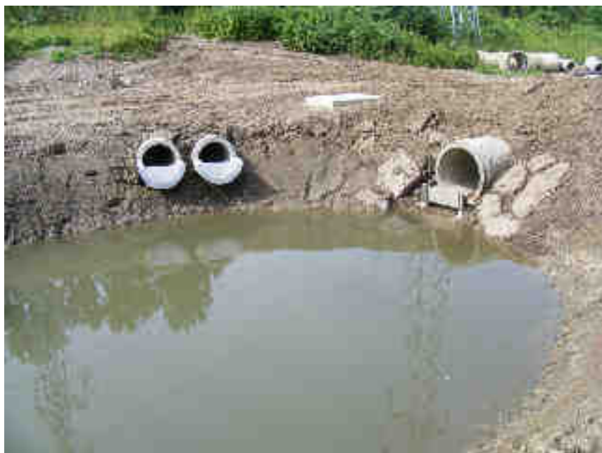
A gauche, canalisation de trop-plein vers le milieu naturel, à droite, dispositif de répartition du débit et enrochements à la sortie du réseau d'assainissement
