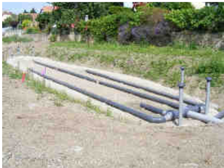
Figure 4-23. Filtre n°3 - Dispositif d'alimentation avec quatre branches de répartition du flux (le 26/06/12)
