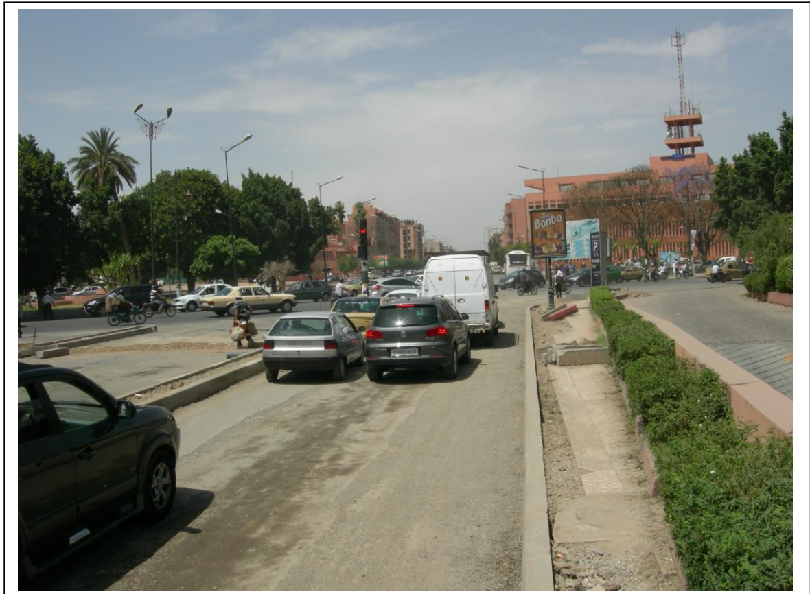
Figure 92. Aménagement de l'avenue Hassan II pour accueillir le BHNS, Marrakech. Cliché : A. NAKHLI, 2014.
