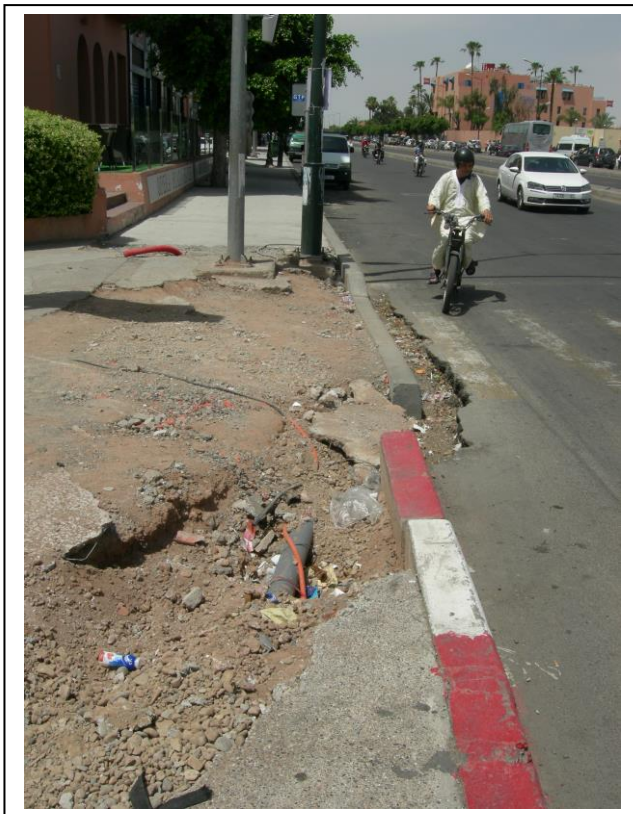
Figure 51. Trottoir inapproprié, avenue Hassan II, Marrakech. Cliché : A.NAKHLI, 2014.
