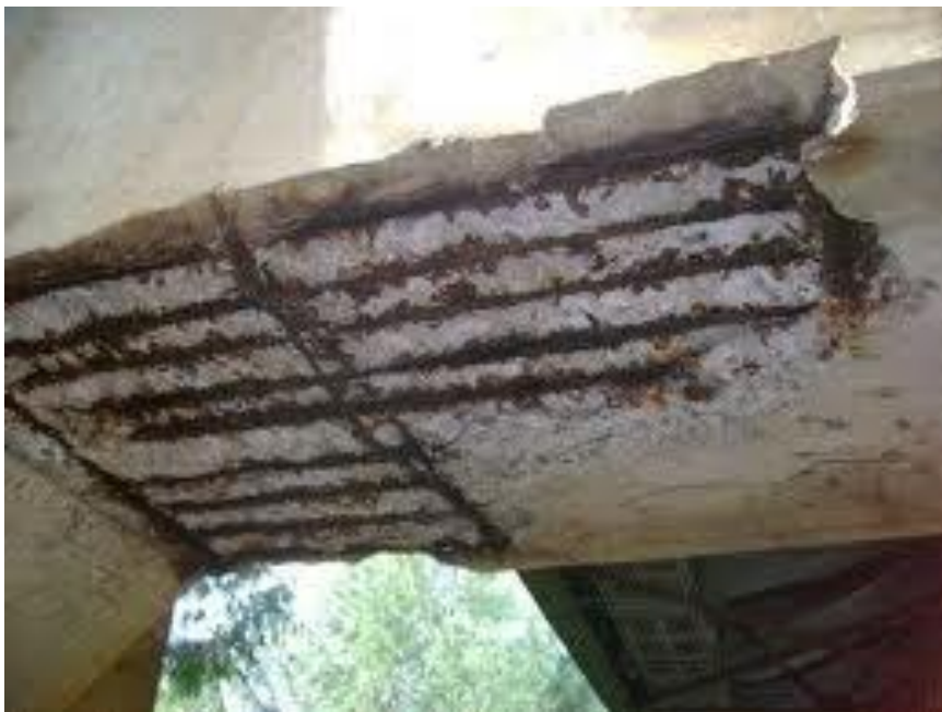
Figure 1 : corrosion de l'acier
