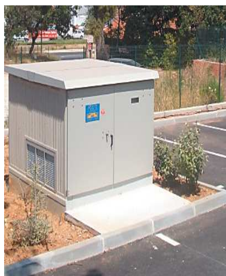
Figure 1.8 : Poste de distribution HTA/BTA type « cabine ».
