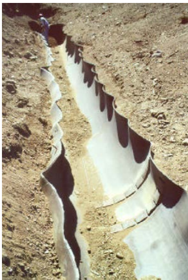
(a) Déchirement d'un gazoduc (Mannucci and Demofonti, 2001)
