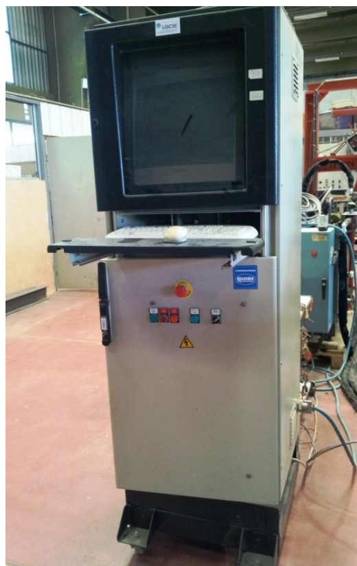
Figure 149 : armoire électrique et baies informatiques pour le pilotage du vérin hydraulique
