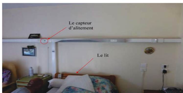
Figure 120 -Intégration du capteur d'alitement dans l'installation électrique dans une chambre d'EHPAD d'Ambazac
