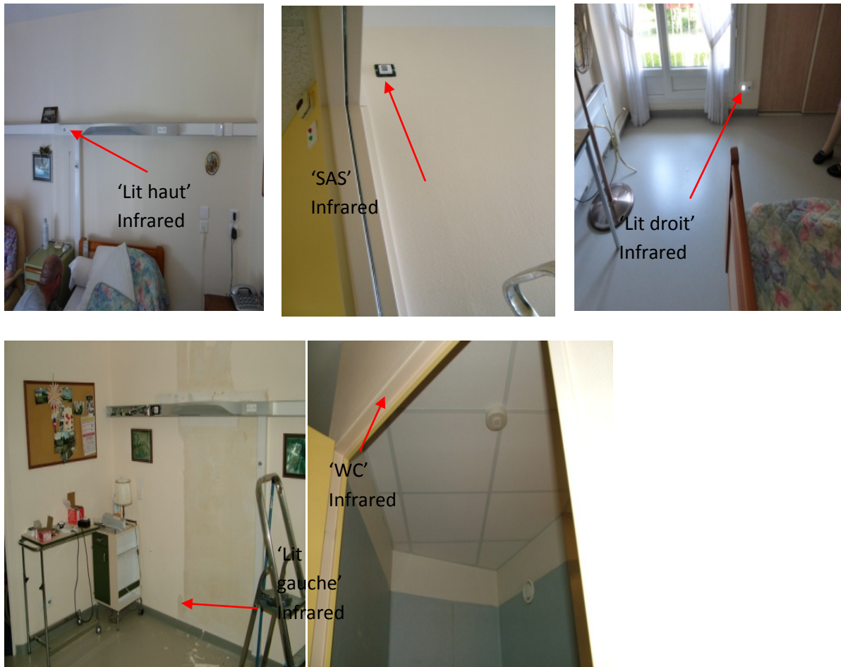
Figure 40 -Cinq capteurs infrarouges installés dans la chambre 'Ch101'
