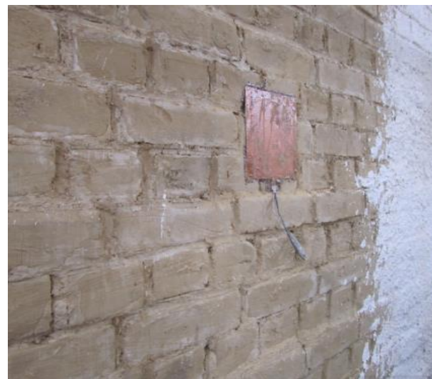
Emplacement du fluxmètre
