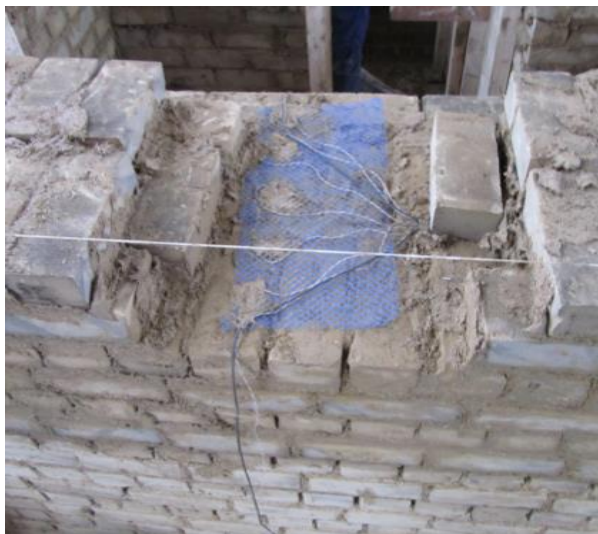
Emplacement des thermocouples
