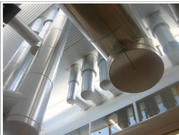
Image des conduits de ventilation de la bibliothèque, source: http://asastjerna.se/works/Avenue.html
