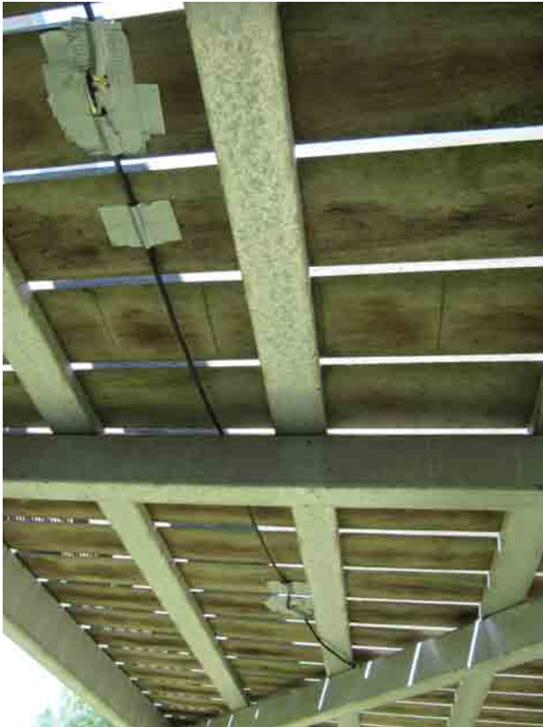
Photographies : Positionnement des microphones sous le platelage de la passerelle Nord
