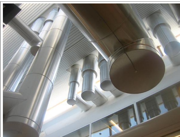
Image des conduits de ventilation de la bibliothèque, source: http://asastjerna.se/works/Avenue.html
