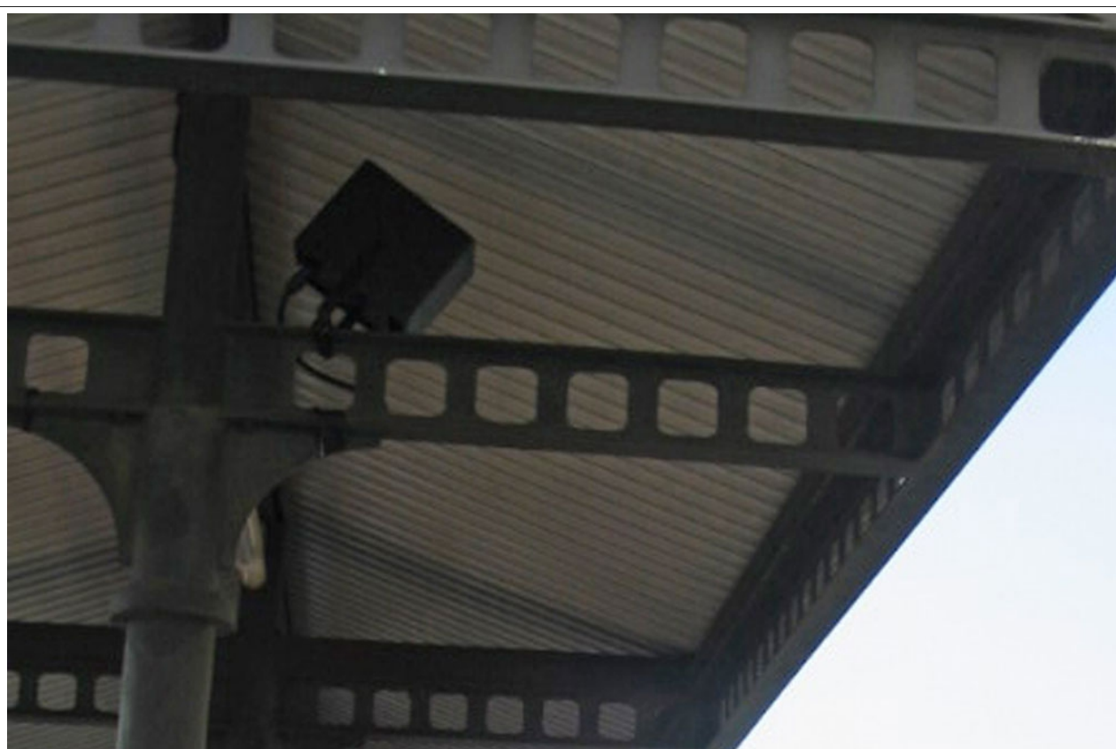
Image d'haut-parleur positionné dans la charpente du toit, source : http://www.lecube.com/fr/tournez-sons-roland-cahen_446
