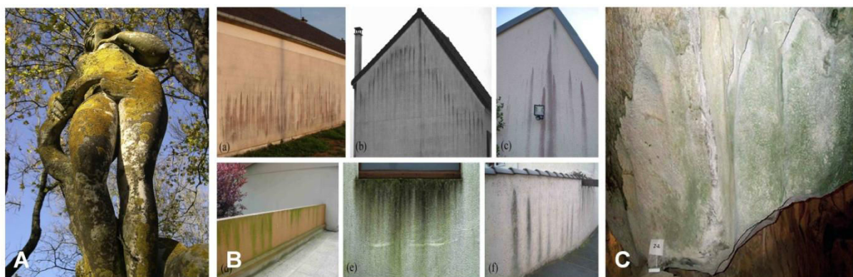
Figure I.1-1: Exemples de colonisation biologique sur différents types de matériau en pierre. A : statue en marbre des jardins du Palace National de Queluz (Portugal) colonisée par des lichens (Miller et al. , 2012). B : différentes façades et structures de bâtiments modernes en France colonisés par les algues (Barberousse et al. , 2007). C : Biofilms d'algues et de cyanobactéries colonisant une paroi calcaire dans la grotte de Zuheros à Cordoba en Espagne (Albertano, 2012).
