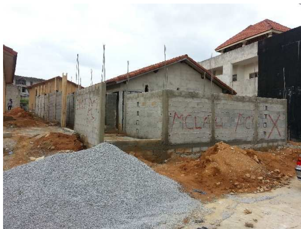
Vue de la même villa en novembre 2013 en cours de transformation. La croix sur le mur avec les initiales du Ministère en charge de la construction indiquent que ces modifications se font sans permis de construire
