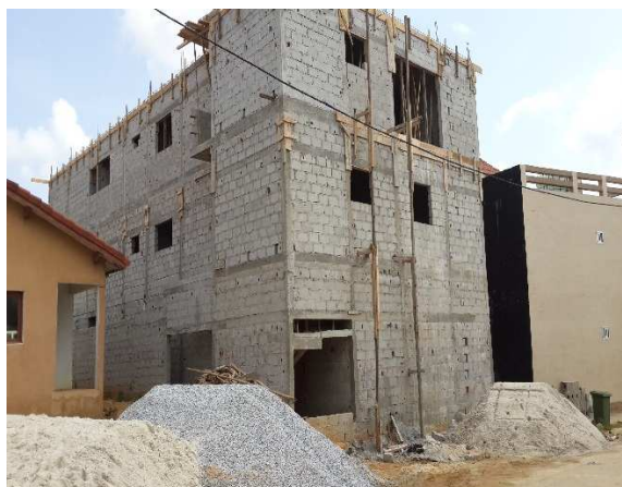
Avril 2014 : transformation de la villa basse en un immeuble de R+2 avec des ouvertures sur le voisin et l'occupation entière de la parcelle
