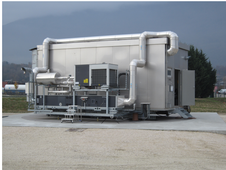
FIGURE 2.4 – Centrale de traitement d’air d’une cellule PASSYS
