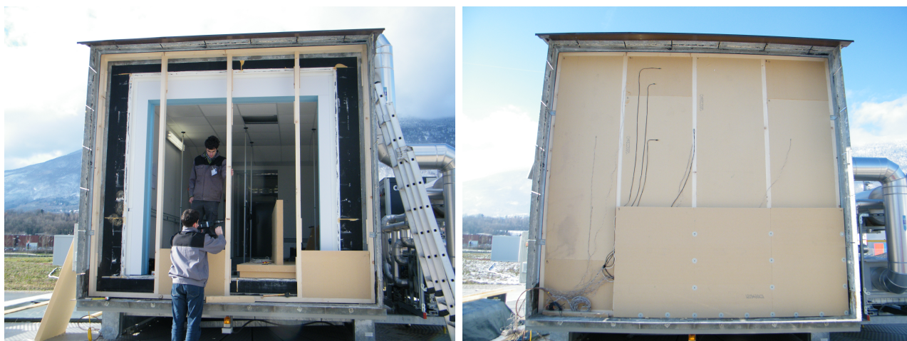
FIGURE 2.8 – Montage de la paroi : Ossature (Gauche), Deuxième couche d'isolant en cours (Droite)
