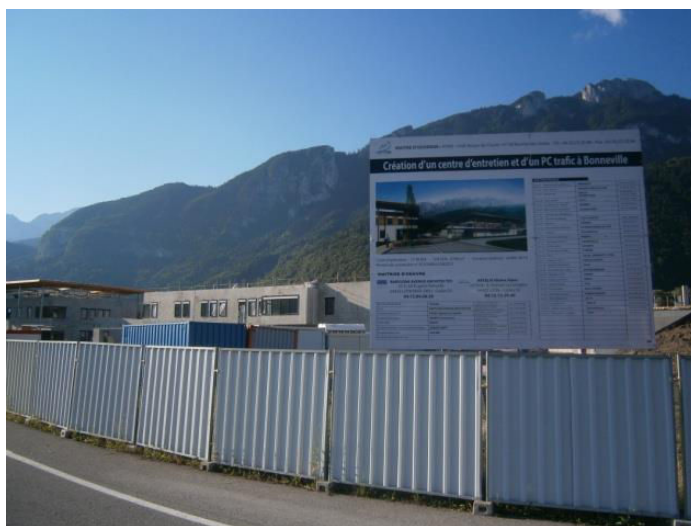
Photo 1 : Chantier du centre d'entretien et de contrôle trafic de Bonneville Cliché : A. Merle, août 2013
