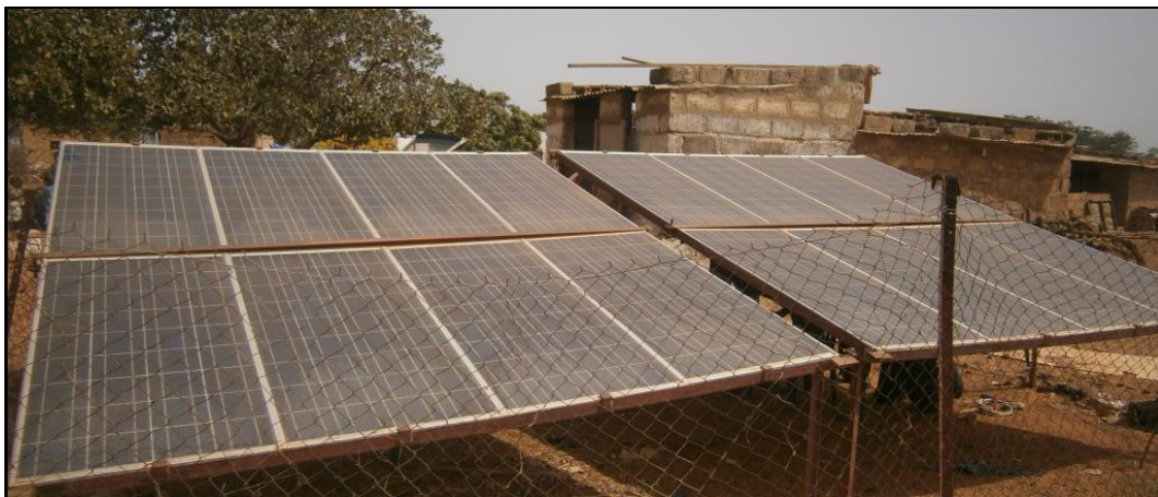
Figure III- 24. Les seize modules polycristallins installés sur le site Kawsara Fall.
