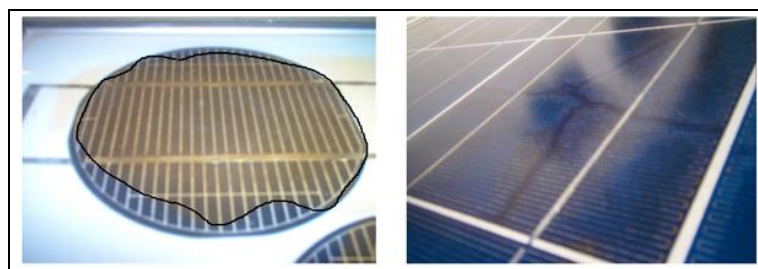
Figure II- 4. Modules photovoltaïques avec des cellules décolorées.
