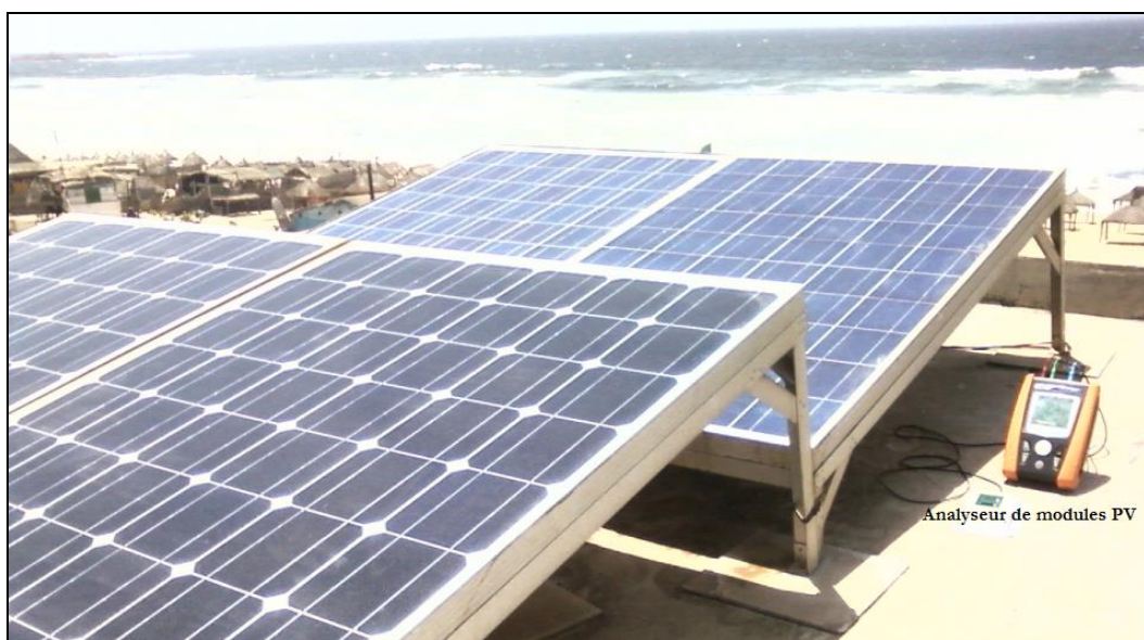
Figure III- 26. Modules exposés sous environnement marin.
