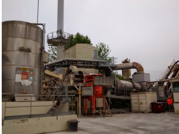
Figure I-14 Unité de production de type Tambour-Sécheur-Enrobeur Ermont à Bouguenais.
