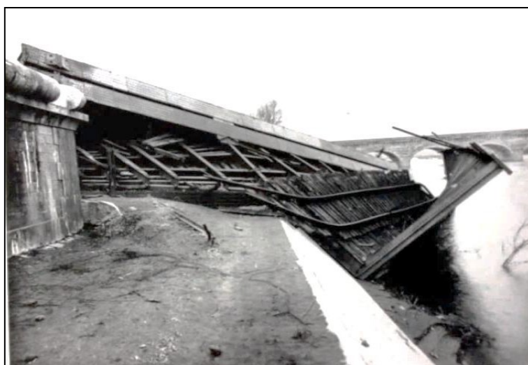
Photo III.2 Les débris du pont Cacor emportés par la crue non-loin du Pont Canal (Source : AD Tarn-Et-Garonne, Série Fi, 3Fi53)
