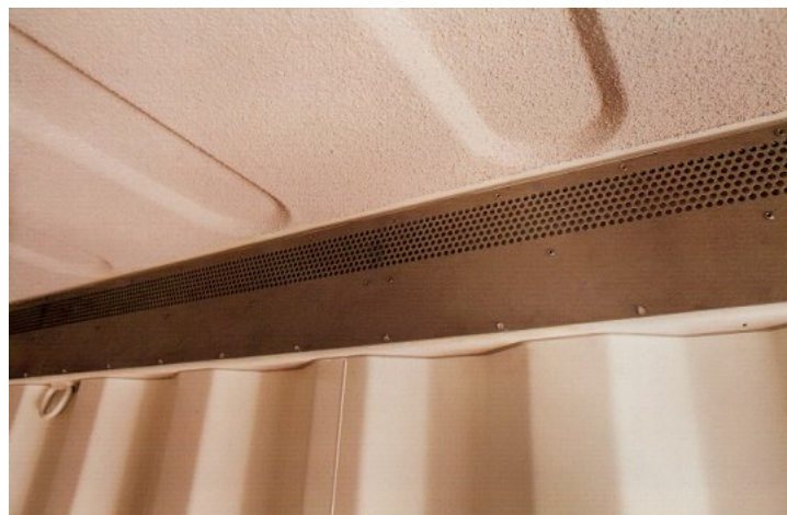
FIGURE 3 – Ventilation d'un conteneur
