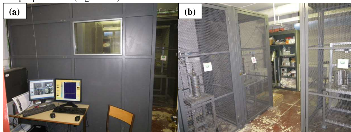
Figure II.9 : poste de pilotage des autoclaves (a) et cages de sécurité (b)
