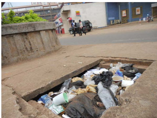
A. Egout bouché au Centre ville
