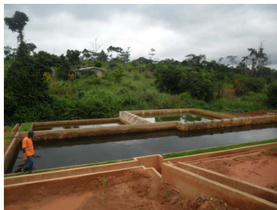
B. Bassins de rétention et de traitement des lixiviats à la décharge de Nkol Foulou
