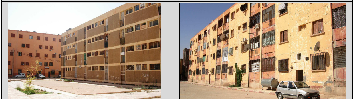
Photos -55- et - 56- Ces bâtiments réalisés au début des années 1960, ont introduit la typologie « barres en béton armé » à Djelfa et sont toujours occupés, malgré l'état dégradé et l'exigüité des logements
