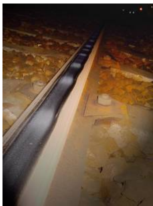
FIGURE 5.1 – Usure ondulatoire du rail
