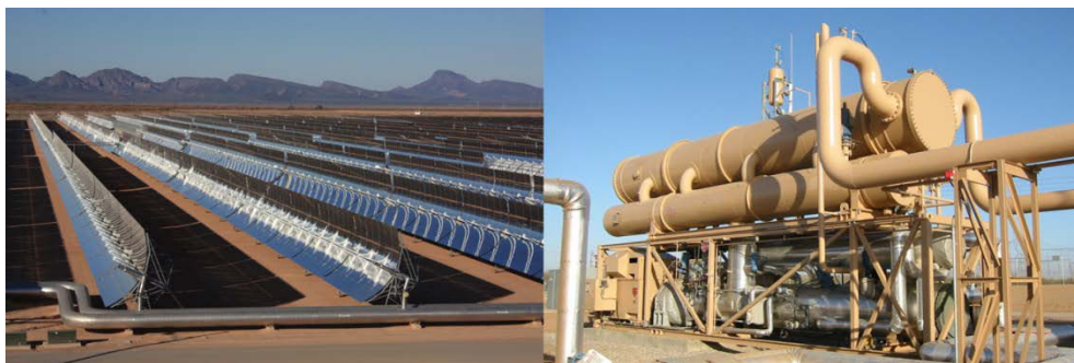
Figure 5 : Centrale ASP Saguero d'1-MWe utilisant des capteurs cylindro-paraboliques et une machine ORC (source : Arizona Public Service Co.)
