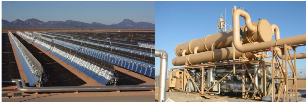
Figure 5 : Centrale ASP Saguero d'1-MWe utilisant des capteurs cylindro-paraboliques et une machine ORC (source : Arizona Public Service Co.)
