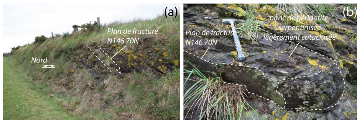
Fig. VI-6 : photographies du talus de la départementale 2 constitué de péridotite serpentinisée. Le plan de fracturation principale est orienté N145 70N (a). Il individualise des bancs pluridécimétriques de péridotites d'aspect cataclasé à débit en cailloutis (b).
