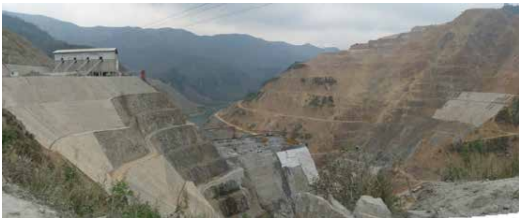
Figure 1. 6: Construction du barrage hydroélectrique de Ban Chat. Source : Nguyen Van Thiet, mission 2010.
