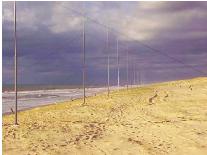
FIG. 4.40 – Réseau d'antennes « fouets » de réception (hauteur : 10m)
